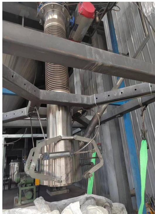
粉尘收集设施
