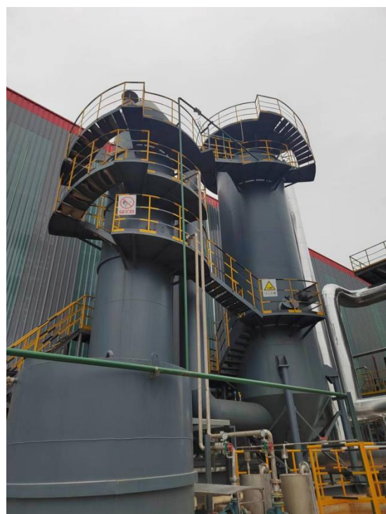
“喷淋塔+电捕焦油器+石灰-石膏法脱硫”设施
