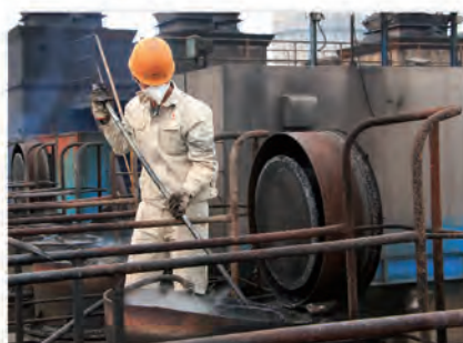
●上升管作为焦炉的咽喉，为保障其畅通无阻，炼焦工耐着高温清理直管口的焦油与石墨浮灰。
