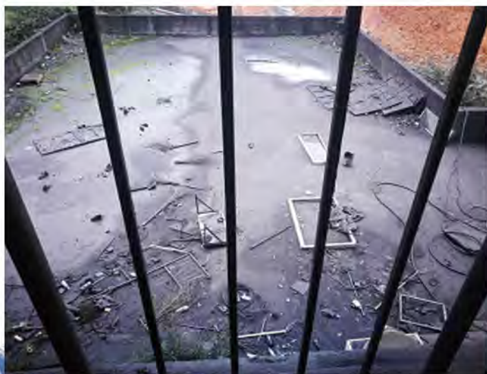
◀ 储运公司 C206转运站： 一层楼顶焦粉、电缆线、破旧窗户等未清理
