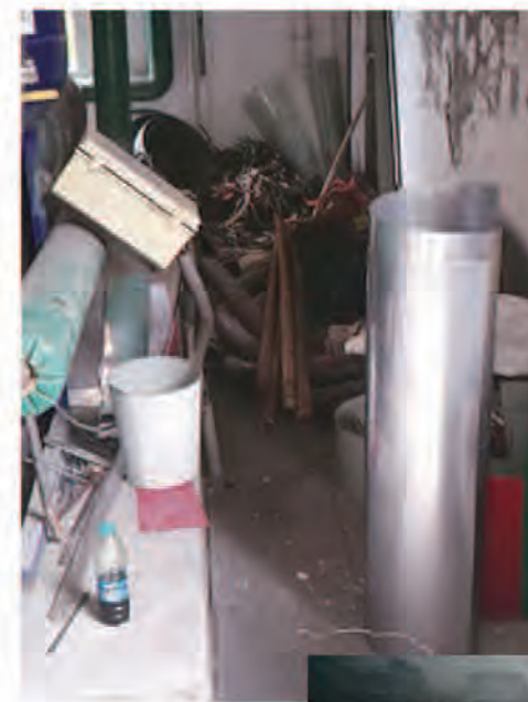
▲动力分厂： 1.室内作为防腐保温作业点应划定作业区域 2.各类物品摆放杂乱，且设备上有积灰。
