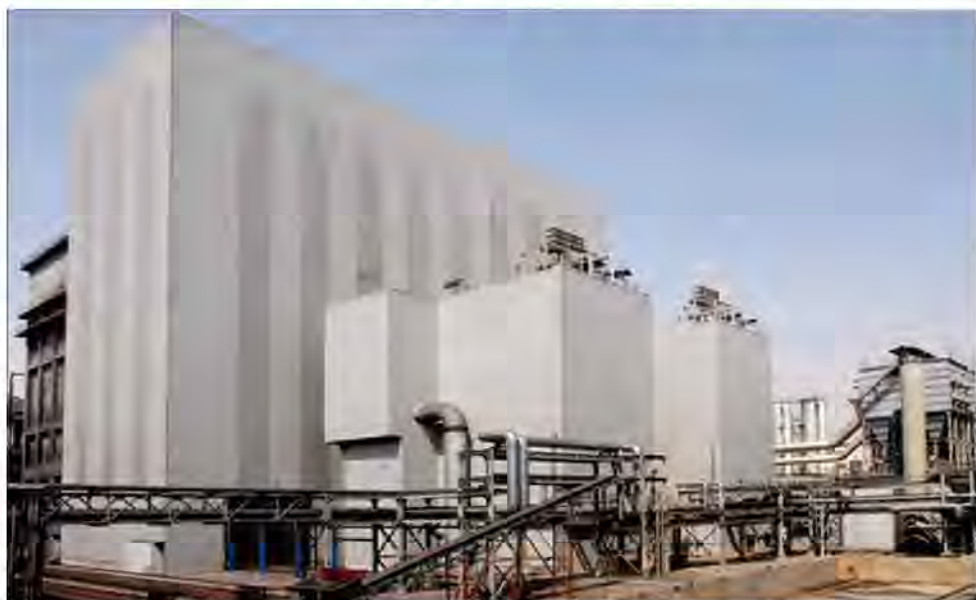
太钢全封闭式140t/h干熄焦装置
