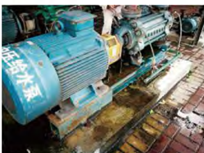
►问题图片（动力分厂燃机区域）：设备漏水后，地面有积水且有青苔。扣罚曹正100元
