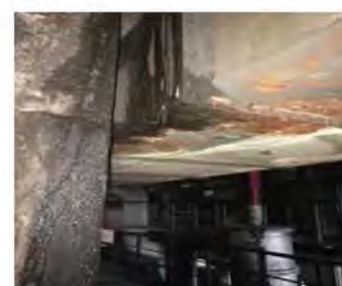
▲问题图片（炼焦分厂捣固焦炉地下室）：现场漏水现象严重，地面长期积水。扣罚陈兵100元
