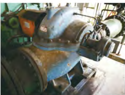
▲问题图片（动力分厂能源公司室外生产区）：设备表面积灰严重，且部分表面附着有油渍。扣罚李海洋、周笑四共100元
