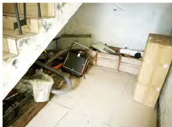
▲问题图片（动力分厂除盐水泵房）：楼梯口存放有不要物，未清理。处罚作业长陶超、王勇共计100元
