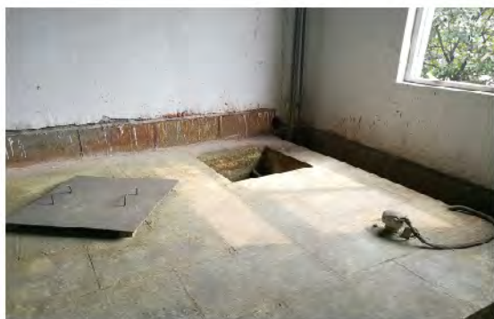
▲问题图片（化产分厂生化工段）：井盖板未及时封盖且无警示标识，存在人员跌落安全隐患。处罚无锡容大100元
