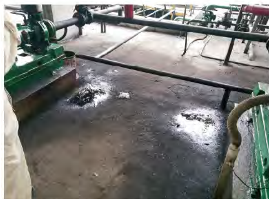
▲问题图片（化产分厂冷鼓工段）：管道漏油导致地面油渍较重。处罚冷鼓工何琼100元
