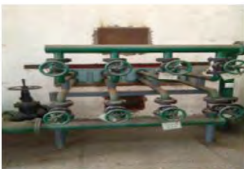
▲现场整改前图片（动力分厂1#-3#汽机厂房）：管道表面灰尘较重，累计考核300元。
