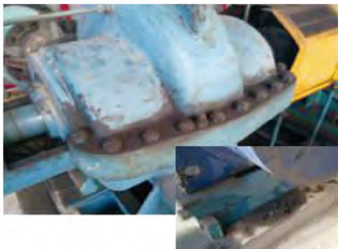
▲现场整改前图片（动力分厂煤压循环水泵）：设备本体污渍较重；机油滴落在地面，现场未采取解决措施，累计考核300元。
