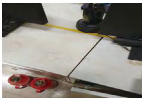
▲现场复查图片（动力分厂自备电厂中控室）：操作台桌面污渍仍未清理干净，累计考核300元。
