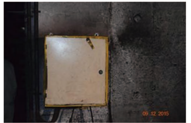
改善中图片（储运公司地下B101煤线皮带检修箱）：箱体明亮无积灰，对箱体边沿使用胶带封堵阻挡粉尘进入箱体；后期需改进封堵方式 ▼
